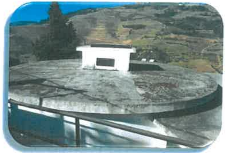
Foto 1 - Reservatório de Covelinhas
