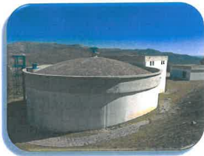
Foto 3 - Reservatório de Viariz da Poça
